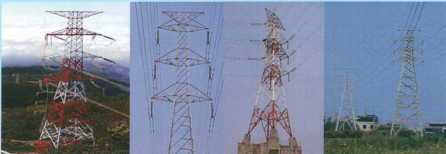
鐵塔型支持物外觀(用於345仟伏、161仟伏、69仟伏)
