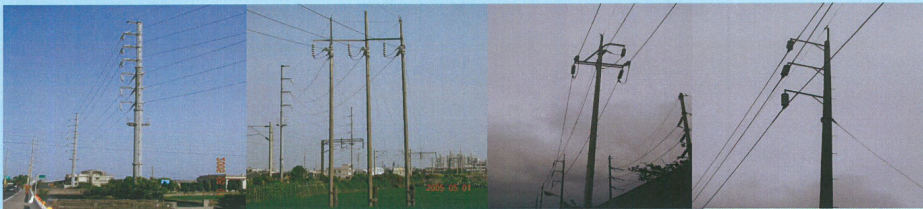
電桿型支持物外觀(大部分用於69仟伏)
